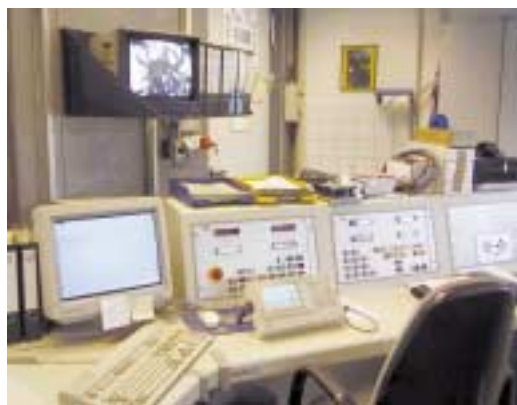
Bild 2: In der Schaltzentrale werden die Fahrzyklen eingestellt und die Testläufe überwacht (im Vordergrund: der Schaltautomat)
